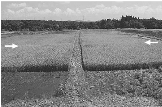
岩手県内陸北部の地震により水田に現れた変位地形(岩手県岩手郡雫石町)。矢印を結んだ線を境として、数+cm程度の左横ずれが生じ、かつ手前側が向こう側比べて20～30cm程度高くなっています。
