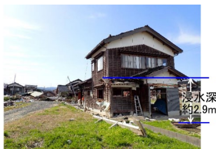
図 12 2024 年能登半島地震の津波被害による建物被害調査と残存住家の事例(片野ほか, 2024)
