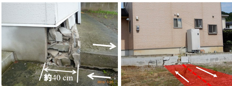
a) 古い在来木造建物(D4) (無筋のコンクリート基礎が破壊) (RC 造のべた基礎等で無被害)
