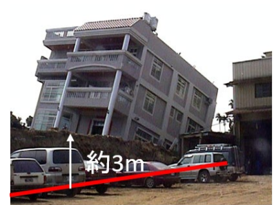
図 11 1999 年台湾集集地震の地表地震断層断層直上で大きく傾斜した RC 造住宅(後に傾斜を戻して修復:久田・田中, 2024)
