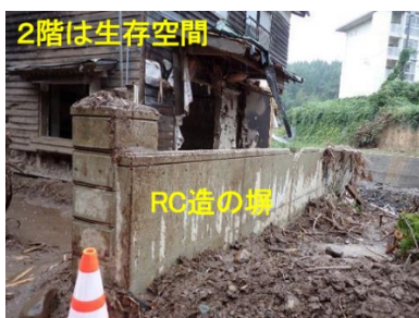
図 14 2024 年奥能登豪雨の洪水による高速流や流木に対して、RC 造の塀により流失を逃れた木造建物の事例
