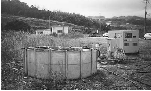
写真1 1,700m孔口横に設置された注水用タンク、ポンプ、および発電機（手前中央から右へ）。遠方の白っぽい建物は野島断層観測室（京都大学防災研究所）
