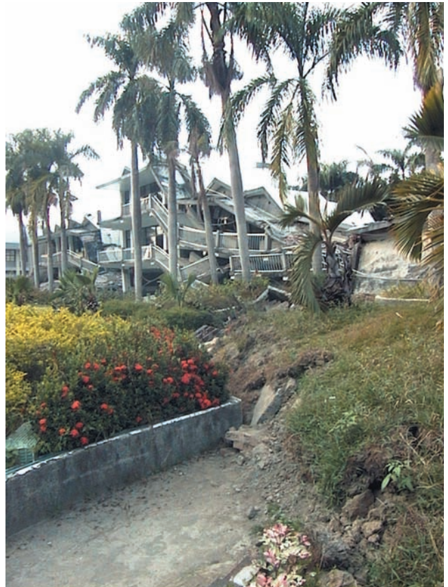
1999年集集地震（台湾）の際に倒壊した学校。この校舎は、写真中央を走る地震断層の直上に位置していた。
