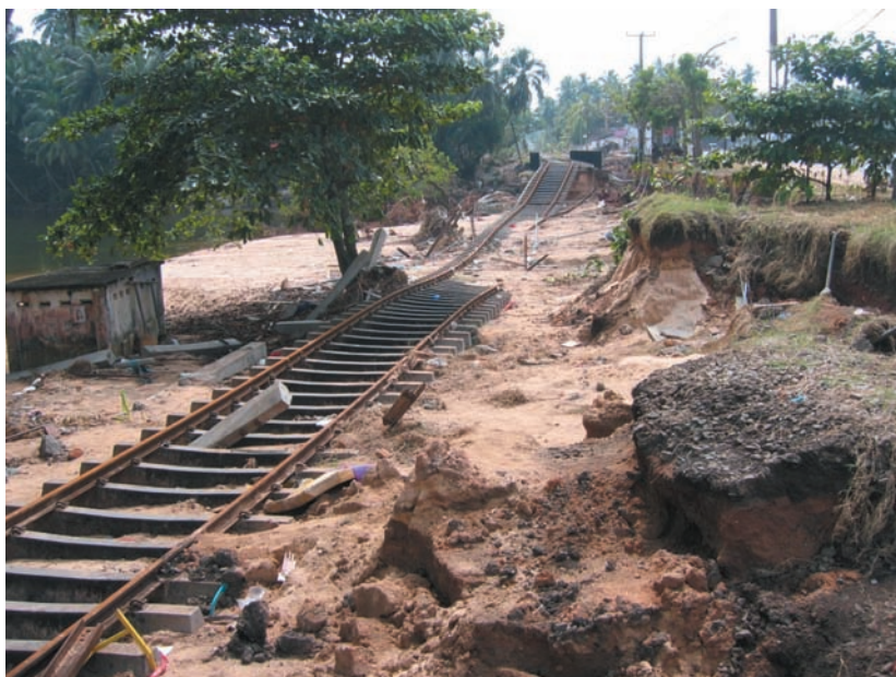
写真2 鉄道基礎の侵食
