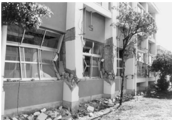
鹿児島県薩摩地方の地震：鹿児島県薩摩郡宮之城町 (九州産業大学工学部建築 楢橋秀衛氏撮影)
