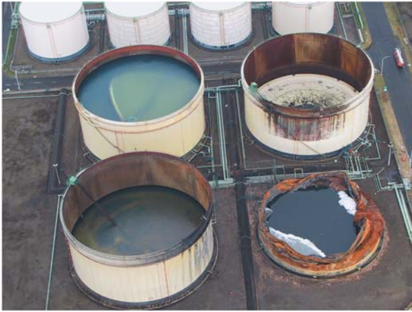
写真1 2003年十勝沖地震の際の長周期地震動により北海道・苫小牧市に立地する石油タンクで発生した浮き屋根沈没被害（札幌市消防局撮影）。
