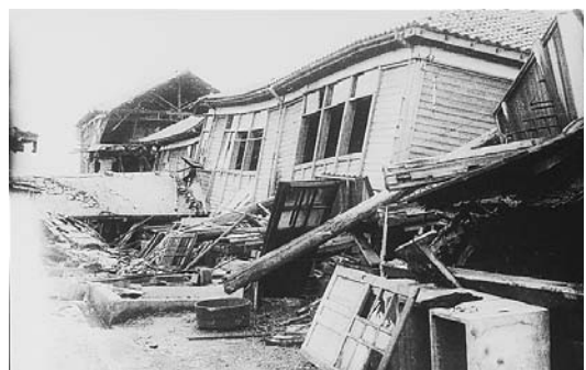
部分的に倒壊した木造小学校校舎（坂井郡）。小林啓美氏撮影・提供。
